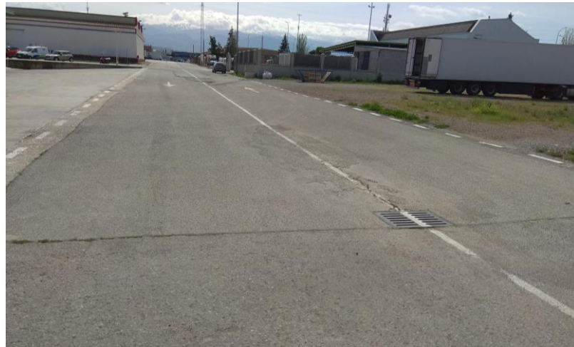
Rejilla de recogida de pluviales y registro de la red unitaria existente en la zona de ZAC
