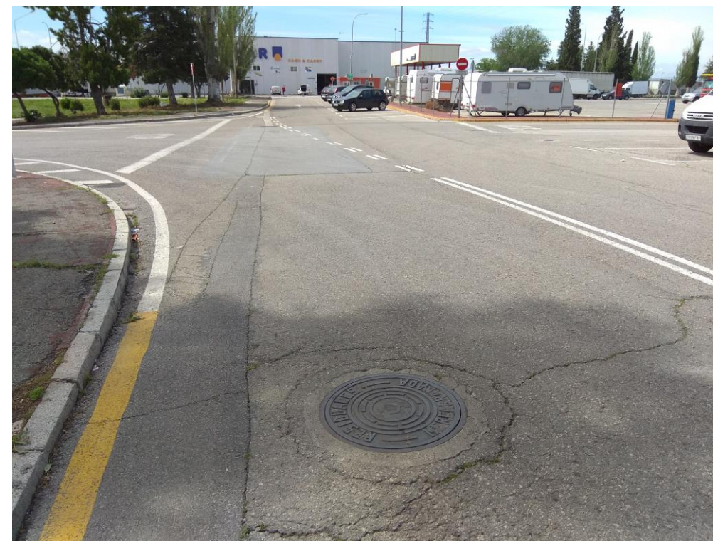
Tramo de la red de saneamiento existente donde se realiza la conexión de la nueva red de la zona ZAC
