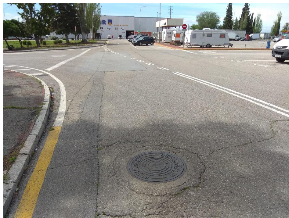
Tramo de la red de saneamiento existente donde se realiza la conexión de la nueva red de la zona ZAC
